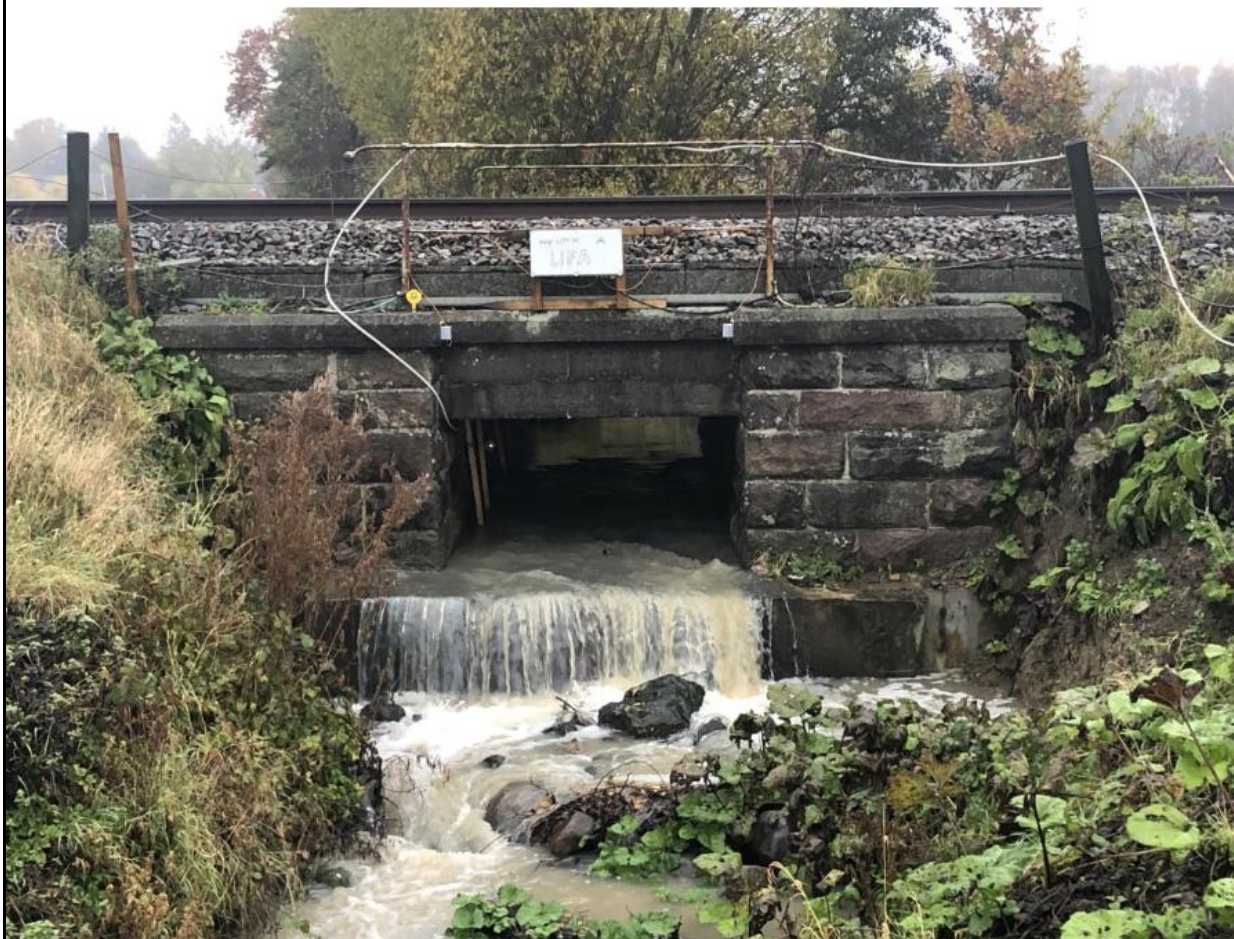
Figur 1 Eksisterende forhold for nuværende stenkiste. Efter nuværende udløb syd for stenkisten opstår et fald på ca. 0,5 m fra eksisterende bund i stenkisten til selve vandløbet, hvilket fungerer som spærring for vandlevende organismer.
