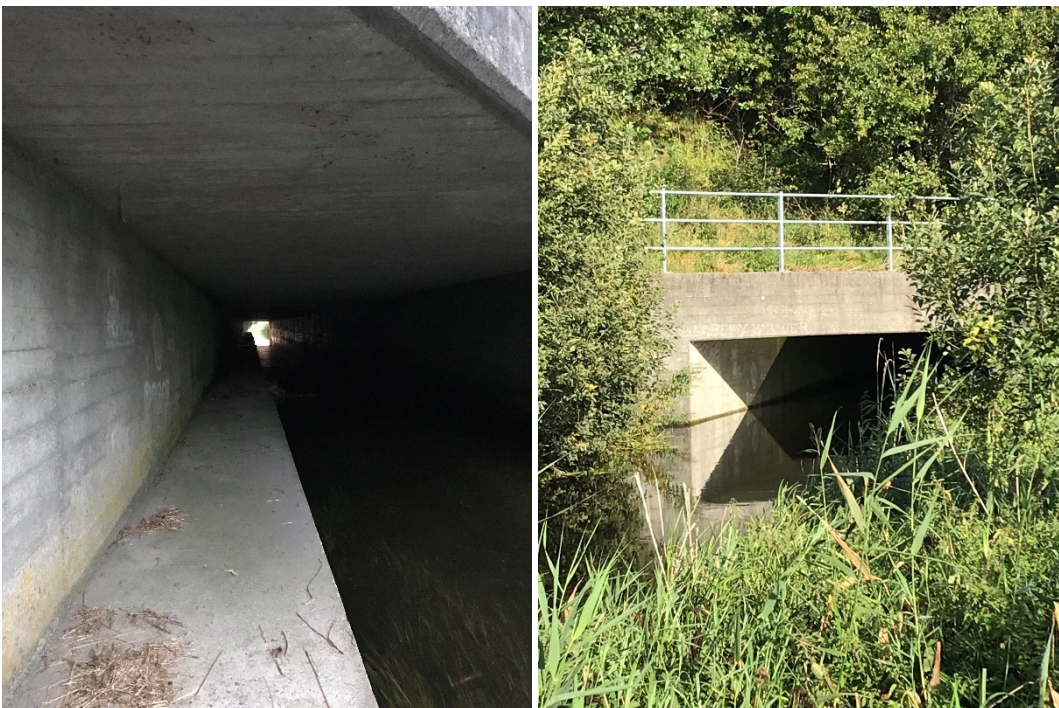
Figur 5-1 Østerås forløb med eksisterende betonbanket (tv.), som ved store vandføringer i Østerå bliver oversvømmet (th).
