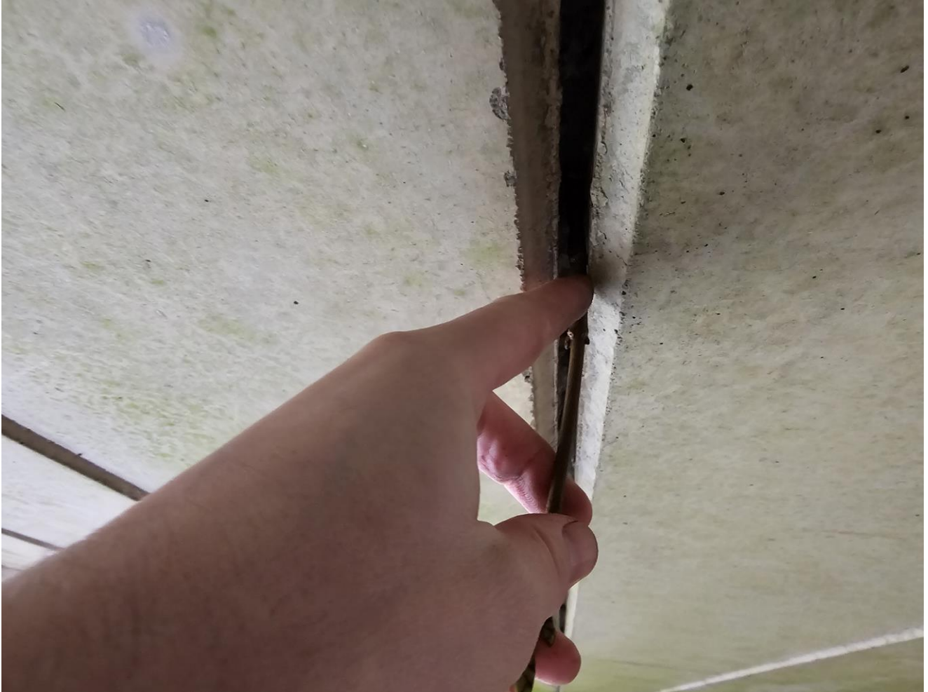
Figur 2.3 En enkelt sprække, der manglede lidt mørtel. Der var ikke plads til en finger, og den var ca. 2 cm dyb.
