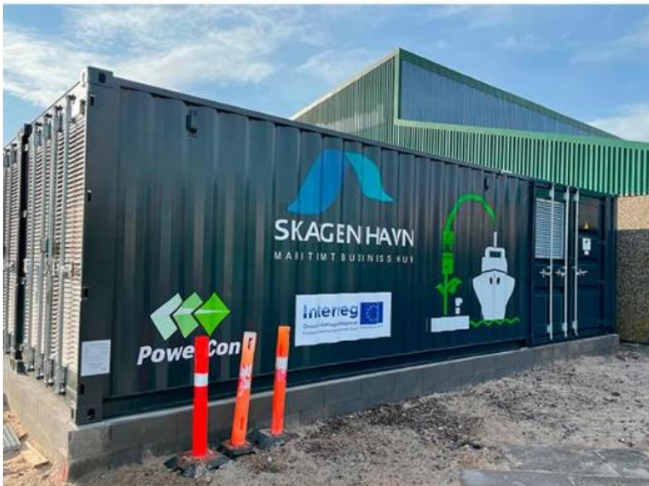
Figur 3 Eksempel på konverter-container
