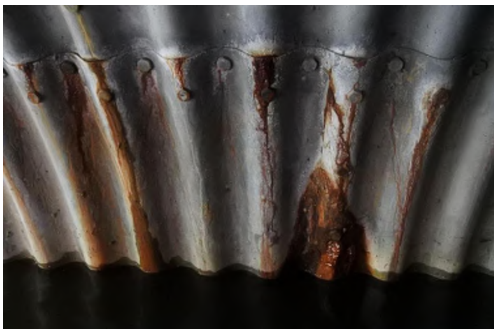
Figur 1: Endeunderstøtninger, med svær korrosion og gennemtæring, Generaleftersynsrapport 2023.
