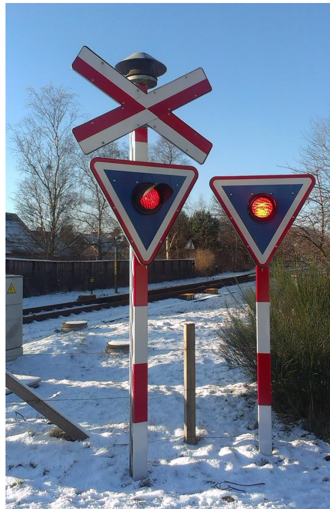
Figur 34. Signaler ved overkørsel ved Svejbæk station
