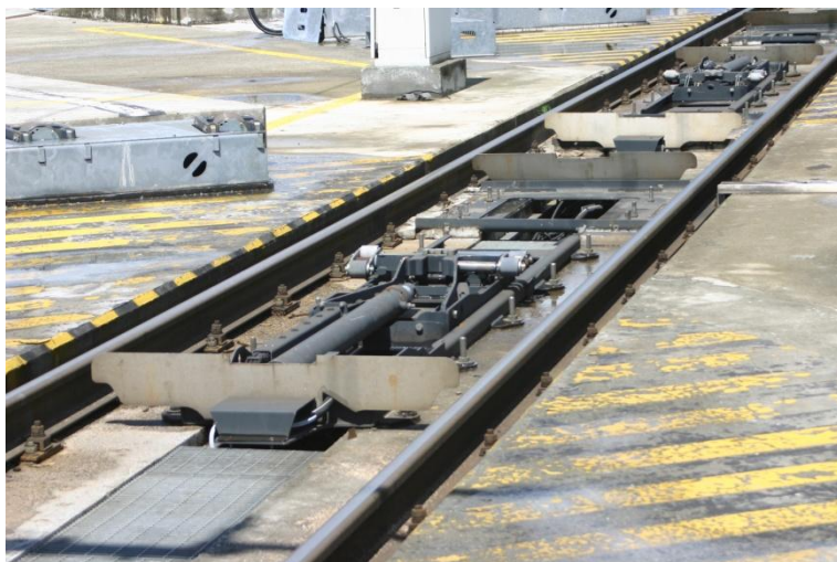
De hydrauliske anordninger til brug for rotation af wagonernes drejeskammel findes monteret mellem skinnerne på læssesporet.
