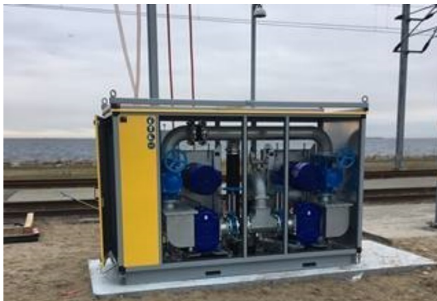
Figur 6-3 Foto af Vakuumsstation.
