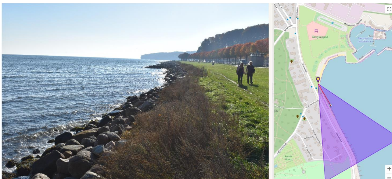
Foto 9 Skræntfodsbeskyttelse langs strandvejen.
