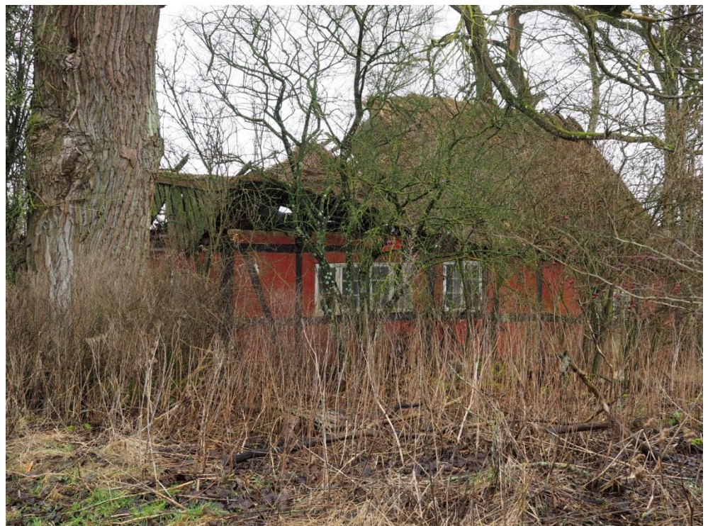
Figur 10-14 Den nordlige af de to faldefærdige bygninger.
