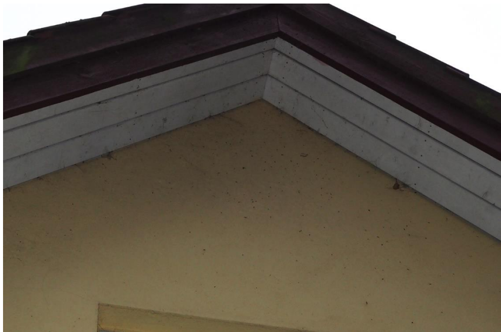
Figur 10-15 Nordgavl af Fladsågårdsvej nr. 5 med mange flagermuseekskremitter.
