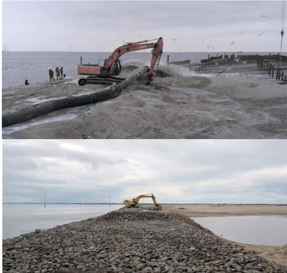
Figur 24.29 Eksempel på anlægsarbejde fra etablering af Esbjerg Havns Etape 4 (Foto: Esbjerg Havn).
