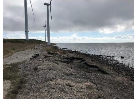
Skader på kystbeskyttelse ved vindmøller
