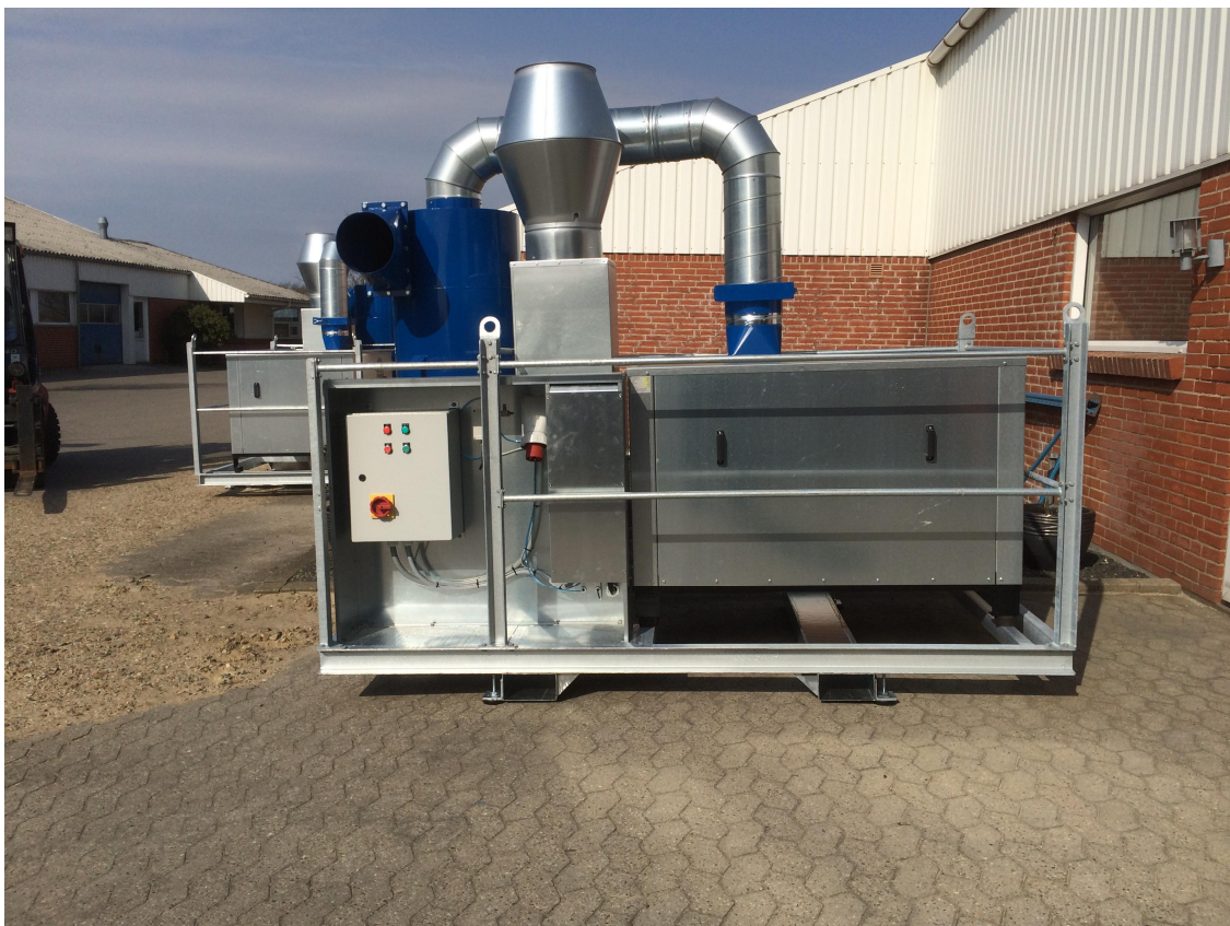
Figur 4 Mobile udsugningsanlæg til udendørsarbejder.
